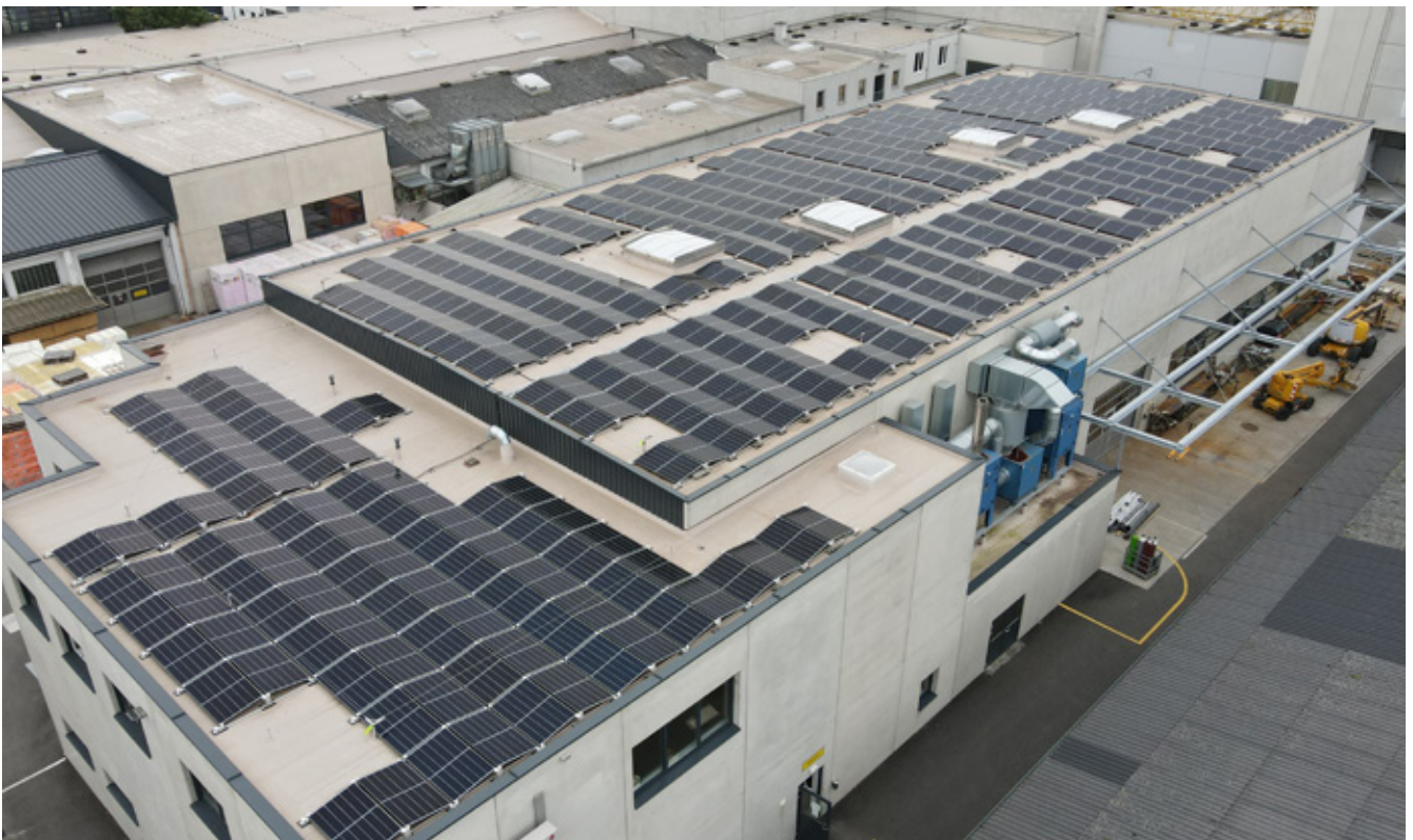
Photovoltaikanlage am Dach des HABAU-Fertigteilwerks in der Naarner Straße 80 in Perg.
